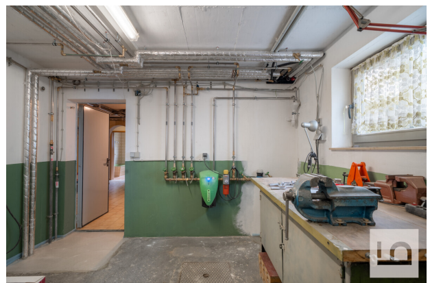
neue Heizungsrohre 2025 und Erneuerung in letzten 10 Jahren
