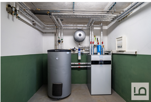
Neue Wärmepumpe-Heizung mit Warmwasserspeicher, Bj. 2025
