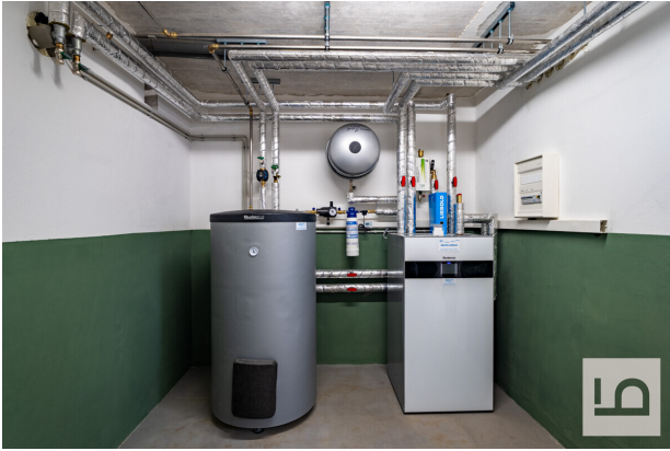
Neue Wärmepumpe-Heizung mit Warmwasserspeicher, Bj. 2025
